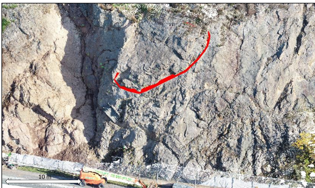
Figur 3. Volymen och glidplanet för ett instabilt bergparti i en bergslänt beräknades. Den bedömda glidyten som styr ett eventuellt ras är rödmarkerad i bilden.
